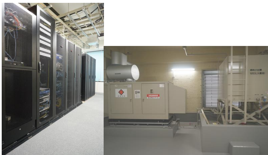
図1 新サーバ室内の様子（左）、非常用発電機と燃料タンク（右）
